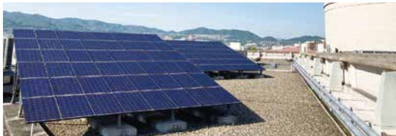
市役所屋上の太陽光発電（30kW）
